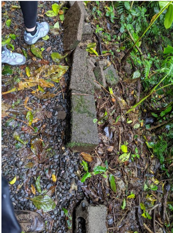
Figure A20. Loose Cinder Blocks, Encantado
