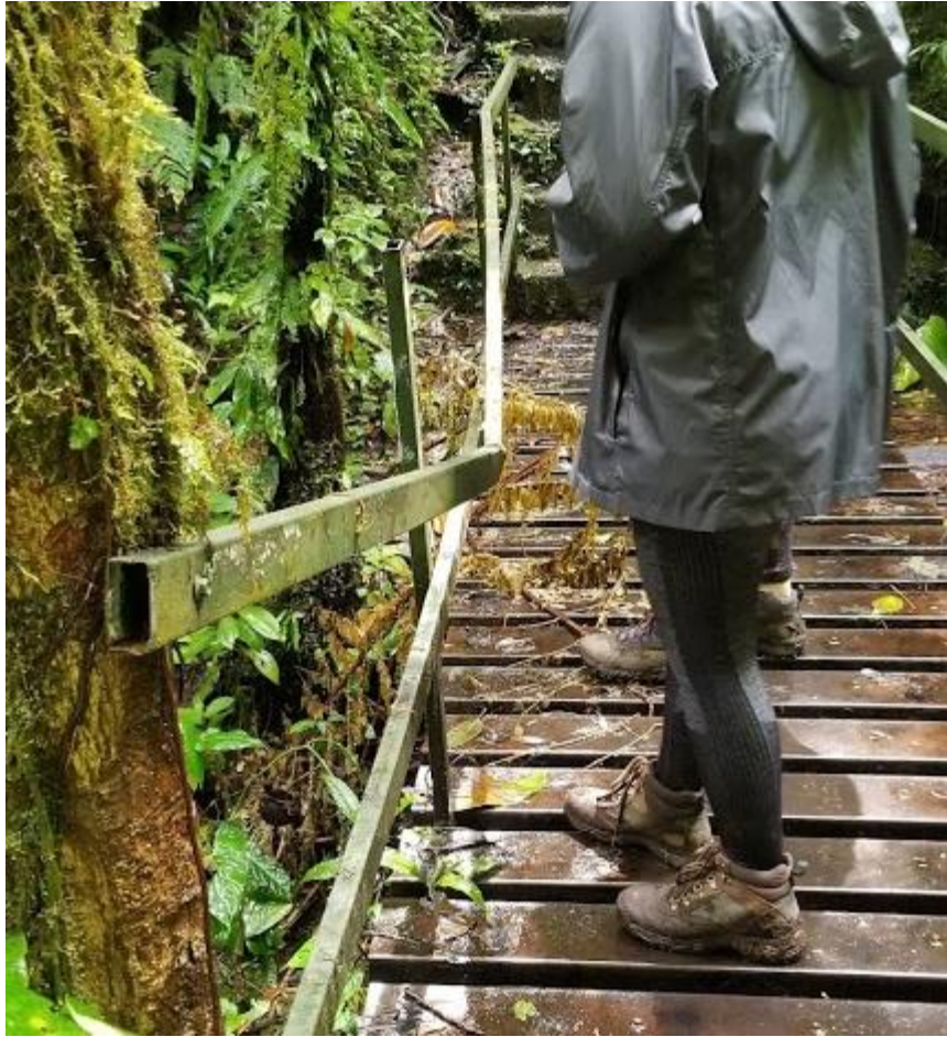
Figure A19. Puente La Planta Broken Railing, Del Bajo
