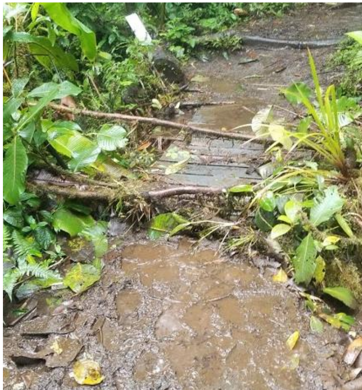
Figure A7. Debris, Puente La Gata, Encantado
