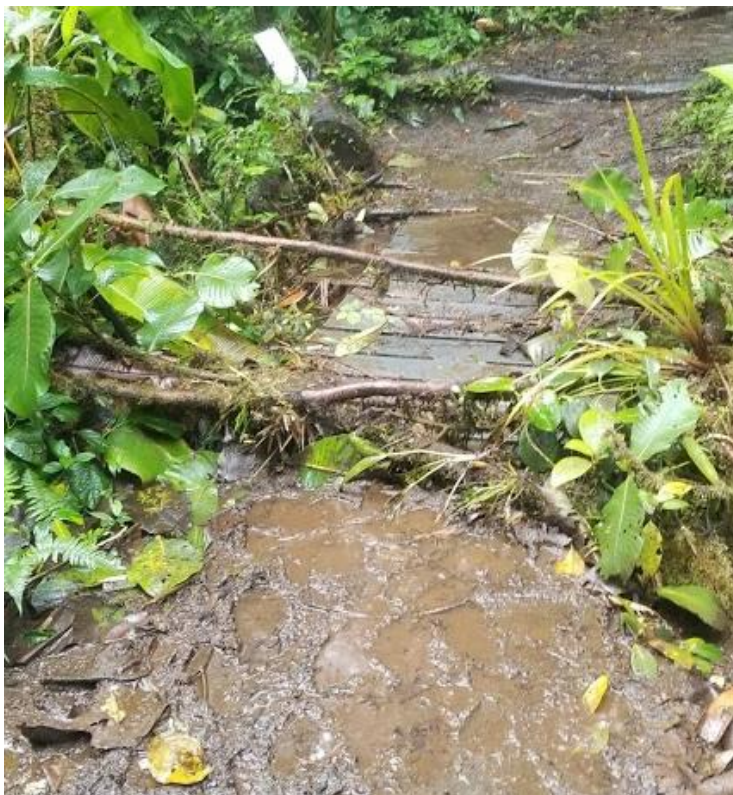
Figure 5. Encantado, Puente La Gata Fallen Branch
