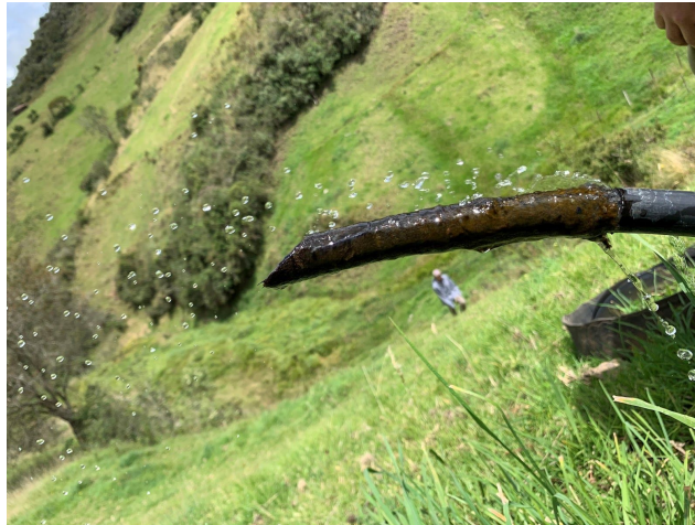
Figura 4: Un punto de capitación con fugas
