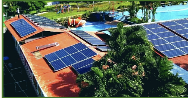
Figura 2: Ejemplo de un sistema de paneles solares
