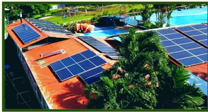
Figura 3: Ejemplo de un sistema de paneles solares
