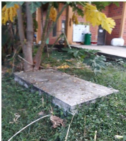
cámara séptica de planta láctea
