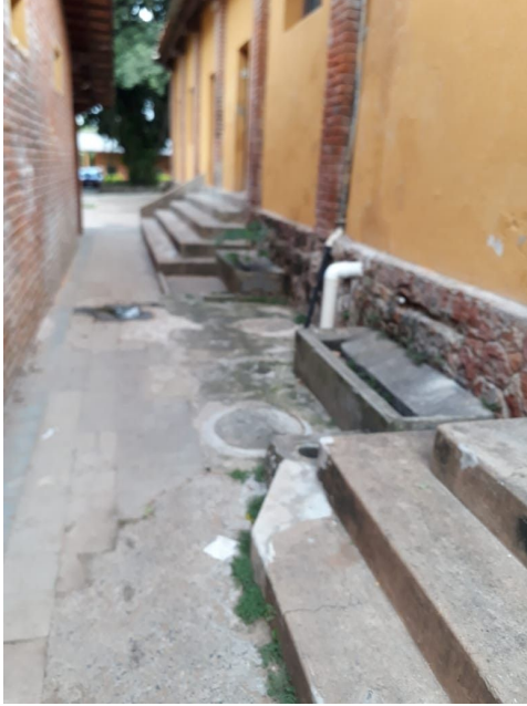
cámara séptica de los dormitorios varones
