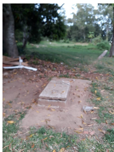
La cámara séptica grande antes del filtro verde
