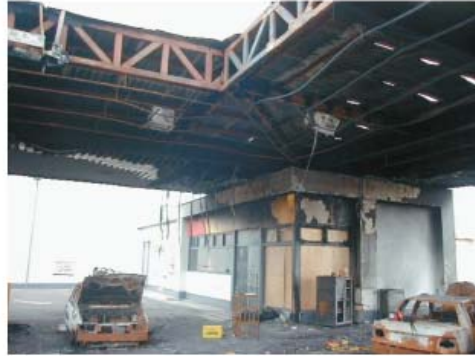
La Tienda de conveniencia sufrió daños en las paredes del costado este y sur, y fractura de ventanales del costado sur.
